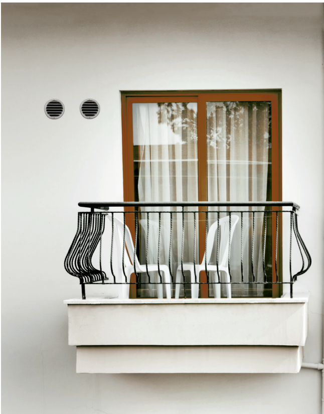
AirBlue GAW 30 ECO: Zwei unauffällige Luftgitter
